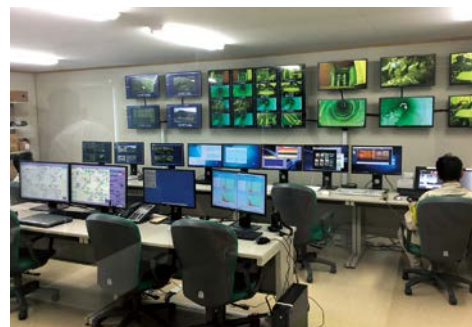
モニタリングルームには多くのモニターが設置され、 分別機の稼働状況を監視するとのことでした (中間貯蔵施設)
