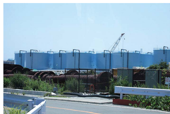
写真5 処理水保管タンク(車窓より): 東電提供
