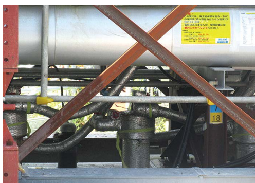
写真4 凍土遮水壁の凍結管(車窓より): 東電提供
