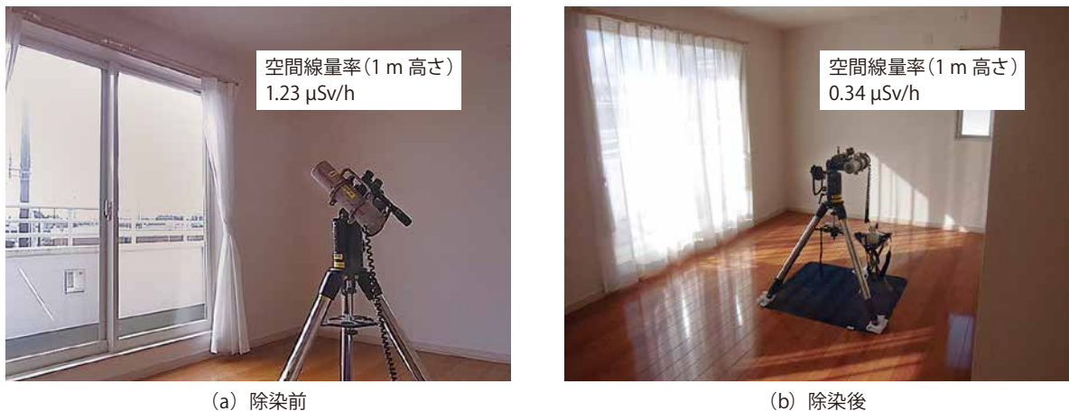
図 12 木造住宅 2 階洋室の設置状況
